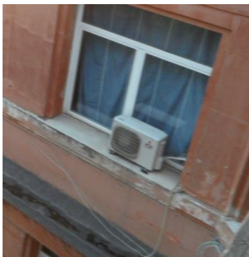
Figura 4.21 – Unità esterna – impianto di climatizzazione estiva
