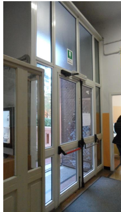
Figura 4.13 - Serramenti in metallo e vetro singolo – scuola materna – Ingresso istituto
