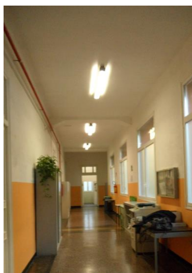
Figura 4.22 - Particolare dei corpi illuminanti ubicati nell’edificio- fluorescente 1x58W
